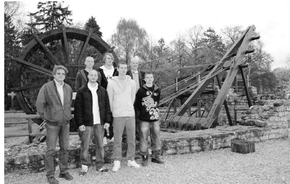
Nach mehr als 10-jähriger Nutzung mussten tragende Teile des bekannten Römerkrans beim Limesmuseum dringend ersetzt werden. Ein Team von Lehrern und Schülern des AZ Bau in Aalen war mehrere Monate damit beschäftigt, die schadhaften Teile auszutauschen.
