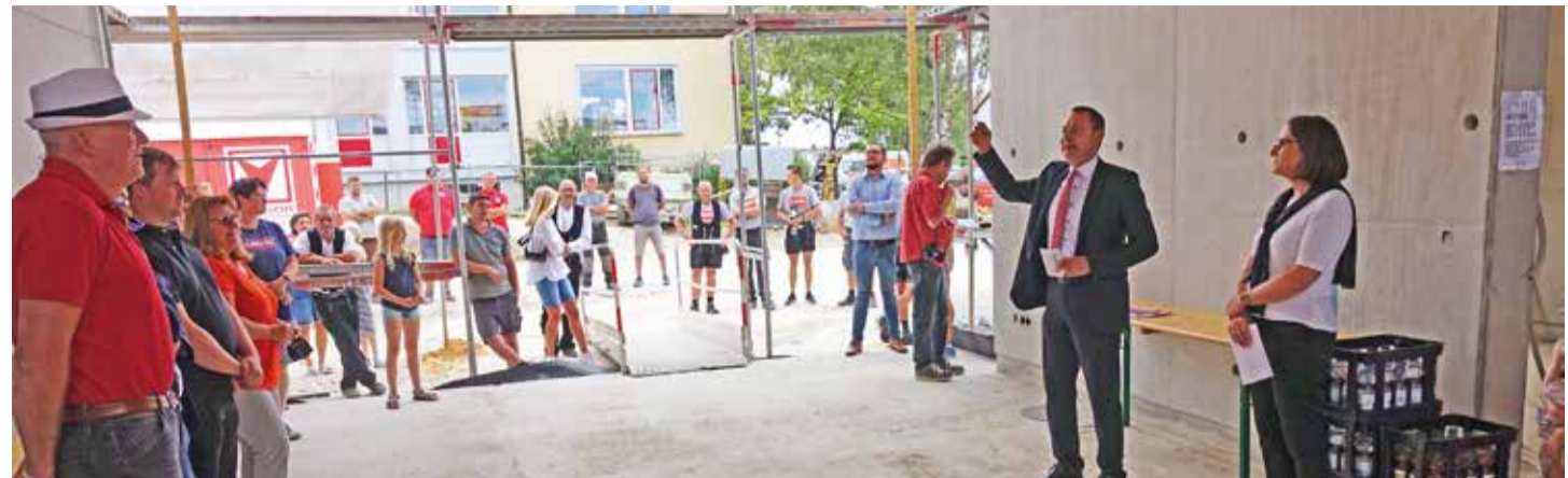
OB Thilo Rentschler und Ortsvorsteherin Andrea Zeißler (re.) betonten den raschen Baufortschritt bei der neuen Kita in Dewangen.
