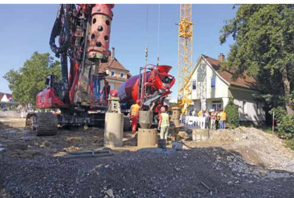
An der neuen Kocherbrücke wird fleißig gearbeitet. Vorige Woche wurden die Bohrpfähle mit Beton verfüllt.
