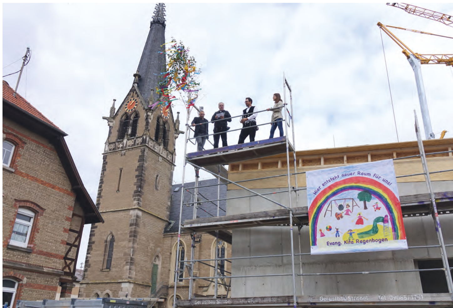
Am neuen Evangelischen Gemeindezentrum wurde Richtfest gefeiert. Es entsteht neben Magdalenenkirche und Altem Pfarrhaus.
