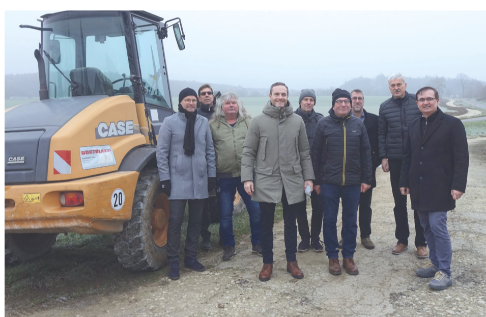
Oberbürgermeister Frederick Brütting (Mitte), Waldhausens Ortsvorsteher Patrizius Gentner (Mitte), Erster Bürgermeister Wolfgang Steidle (rechts) mit Vertretern des Ortschaftsrates Waldhausen, der Fachämter und der Baufirma Bortolozzi an der Baustelle des Fahrradweges. Foto: Stadt Aalen
