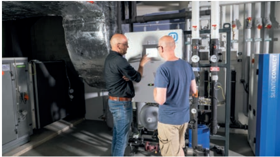
Durch die zwei Wärmetauscher im Keller des Gebäudes ...
