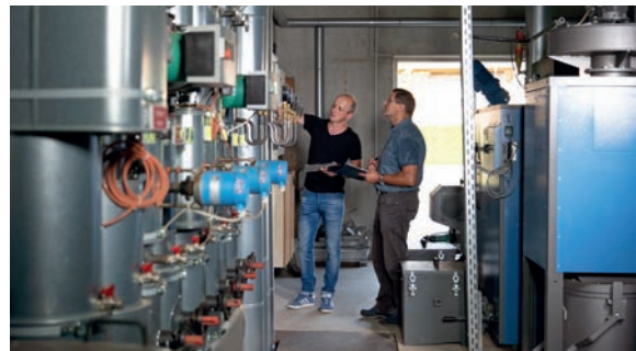
Kontrolle der Heizanlage
