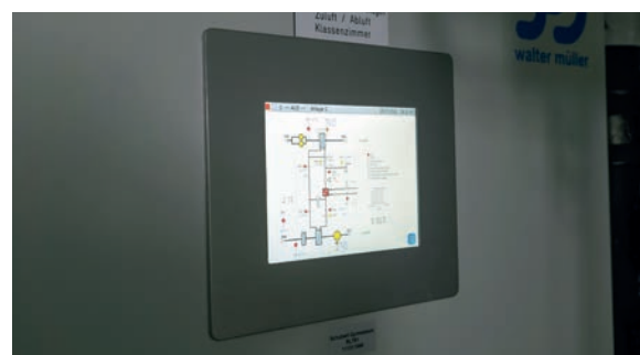
Alle Parameter können stets aufeinander abgestimmt werden
